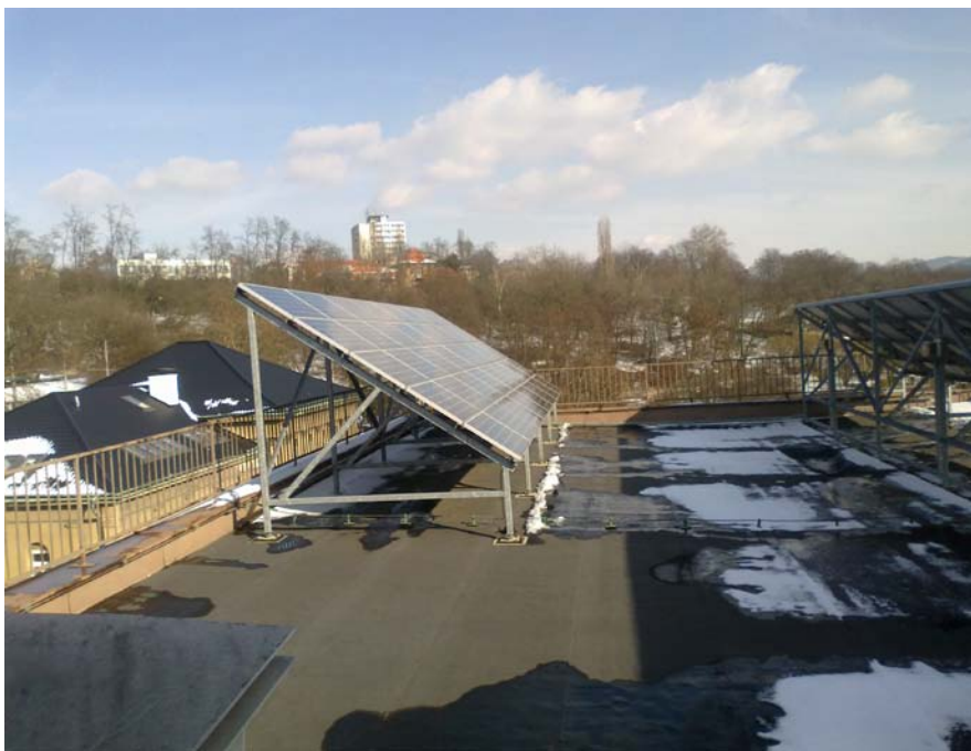
Část fotovoltaických panelů na střeše budovy Fakulty životního prostředí Univerzity J. E. Purkyně v Ústí nad Labem. Instalovaný výkon je 20 kW (2015). Foto: Miroslav Richter
