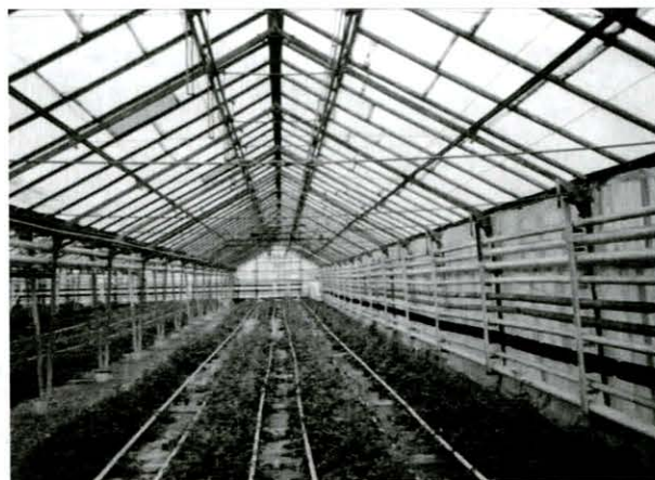
Vykurovacia sústava v skleníku Podhájska. Foto: J. Takács
